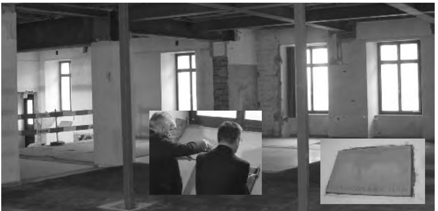
Die beiden Regierungsräte Hans Peter Ruprecht (links) und Bernhard Koch beim Einmauern der Kupferkassette
